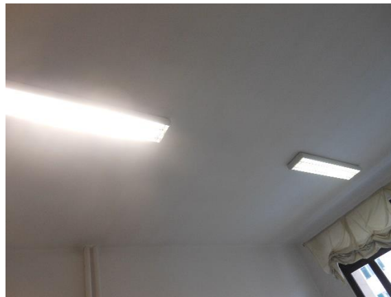
Figura 4.15 - Particolare dei corpi illuminanti ubicati nelle aule
