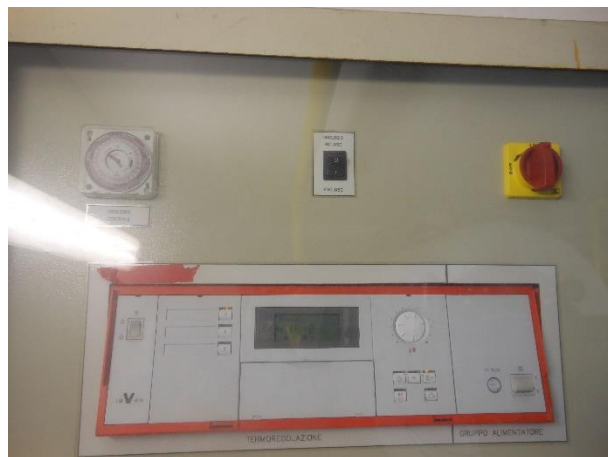
Figura 4.6 - Particolare della centralina di controllo in centrale termica (curva di compensazione climatica e telegestione)
