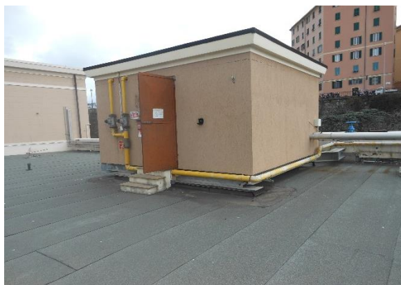
Figura 4.10 - Particolare della centrale termica in copertura
