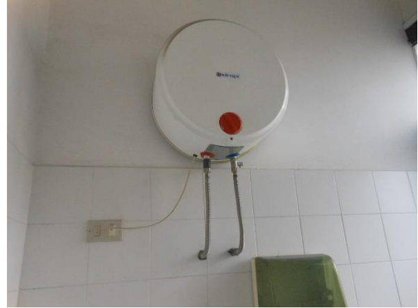
Figura 4.12 - Particolare di un boiler elettrico per la produzione di acqua calda sanitaria
