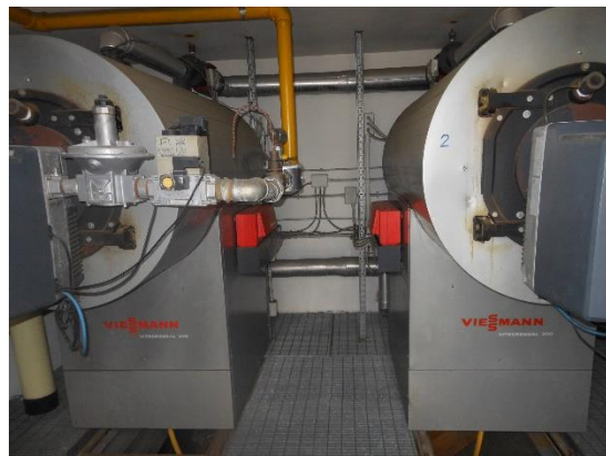
Figura 4.11 - Particolare dei generatori di calore
